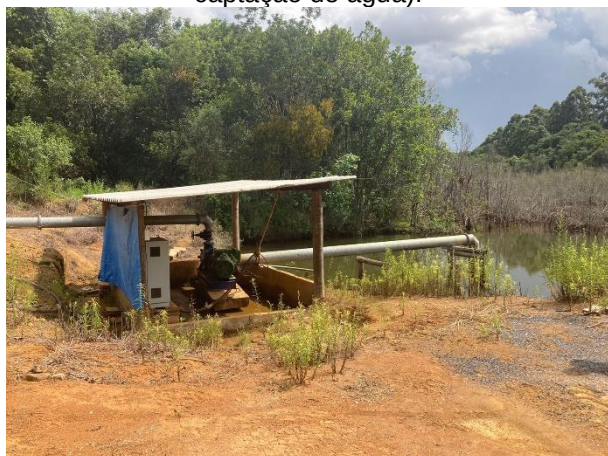
Figura 08: Sistema motobomba (Ponto de captação de água).
